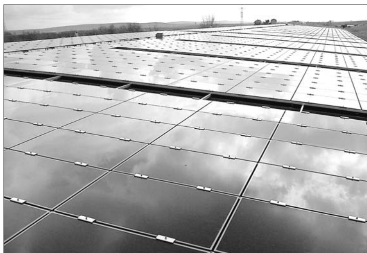
PLANTA SOLAR. Primer tejado solar del proyecto Guadalquivir.
